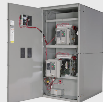
Interruptores de transferencias
