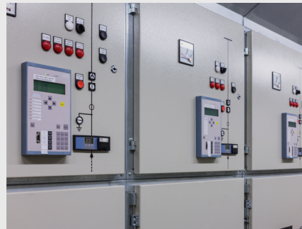
Celdas de Media Tensión
