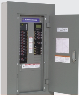
Centro de control de iluminación
