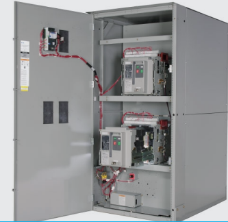
Interruptores de transferencias
