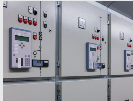
Celdas de Media Tensión
