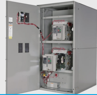
Interruptores de transferencias
