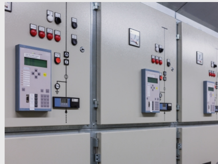
Celdas de Media Tensión
