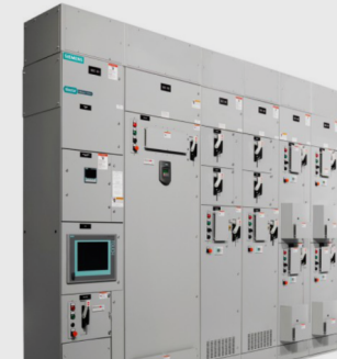
Centro de control de Motores (MCC)
