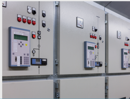
Celdas de Media Tensión
