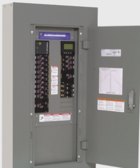
Centro de control de iluminación
